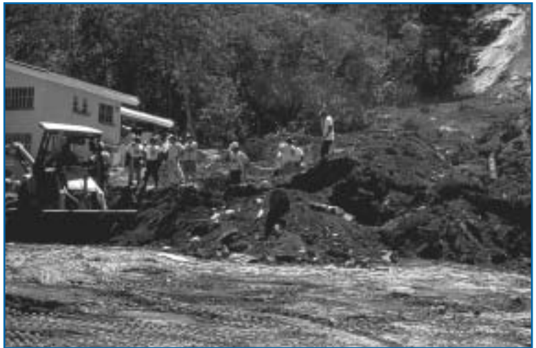
Generación de escombros después del terremoto de El Salvador.
