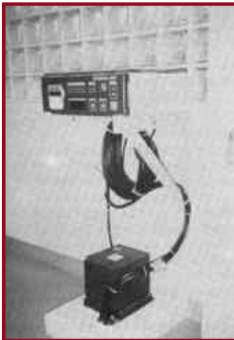
Figura 100. Interruptor sísmico que controla la válvula de corte en Yokosuka, Japón.
