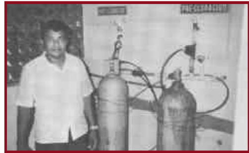
Figura 1. Cilindros de cloro que fueron reemplazados luego de volcarse en una planta de tratamiento de agua en Limón, Costa Rica, lo cual ocasionó la ruptura de la tubería de conexión y el escape de vapores de cloro. Una persona tuvo que ser hospitalizada.
