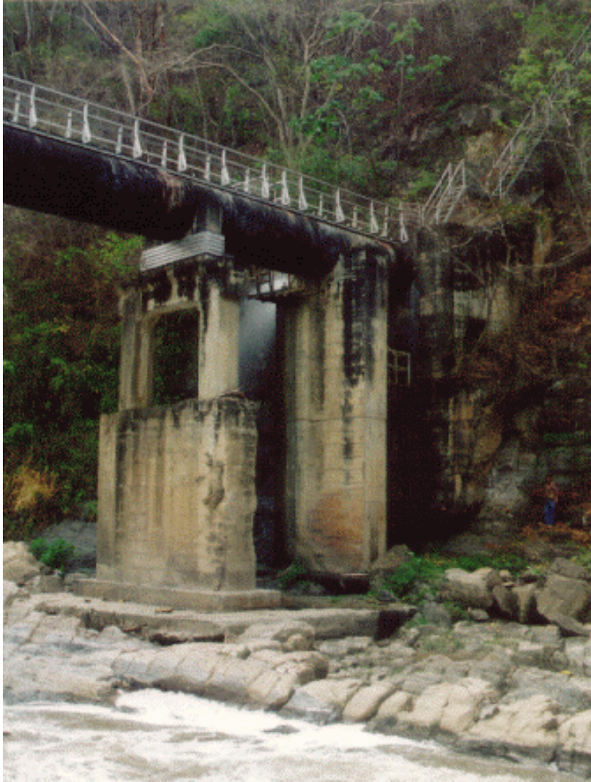
Foto 5.2. Puente B (río Guaire) en zona de difícil acceso. Actualmente se accede por medio de la escalerilla de la mano derecha que conduce a una carretera que finaliza 20 metros más arriba.
