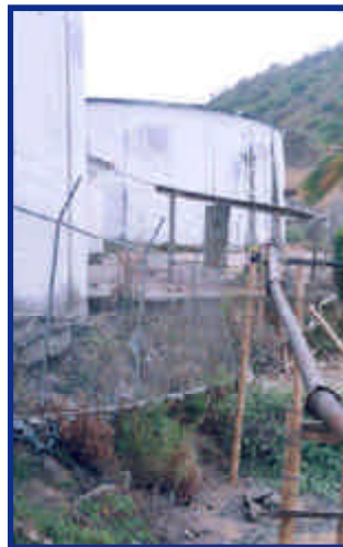
Foto 34. Tanques Gemelos. Obsérvese la socavación existente, la ausencia de suelo y la ubicación de la tubería, que se encuentra descubierta y reinstalada como resultado de los deslizamientos provocados por las lluvias. Se puede ver, asimismo, la colocación de la tubería sobre marcos H de caña guadua y madera (febrero de 2000).
