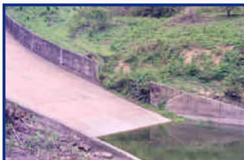
Foto 15. Represa de Poza Honda. Se puede observar parte del cuenco amortiguador izquierdo destruido (febrero de 2000).
