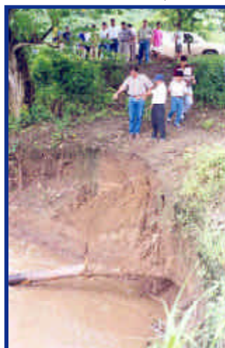
Foto 29. Tubería arrastrada y desplazada por el agua, y parte de la carretera destruida (febrero de 1998).
