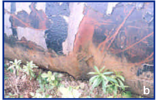
Fotos 36 a y b. Tubería de acero de 600 mm colocada sobre la superficie del suelo. Se observa el estado de deformación y oxidación (febrero de 2000).
