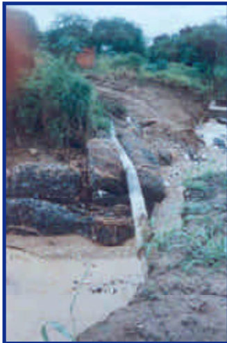
Foto 3. Destrucción de muros de gaviones y tuberías. Sector Cerro de Hojas (abril de 1998).
