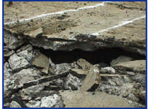
Foto 27. Pavimento destruido y asentamiento del suelo como producto de la rotura de una tubería de aguas servidas (marzo de 2000).
