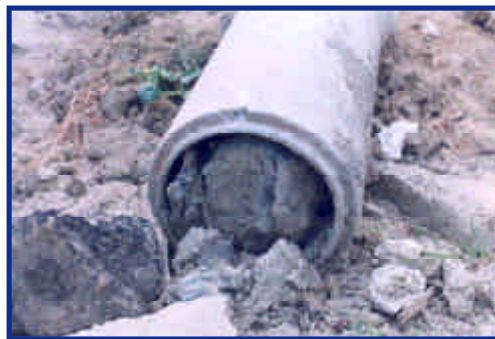
Foto 35. Taponamiento en la tubería del sistema de alcantarillado producto de la sedimentación. Red de aguas servidas (mayo de 2000).
