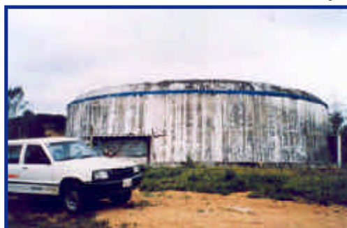
Foto 49. Tanque de Tonsura. Nótese a la derecha el desajuste de la cúpula del tanque (octubre de 1998).
