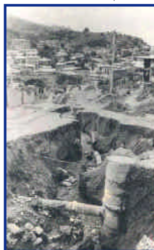
Foto 25. Destrucción de las instalaciones sanitarias provocada por las lluvias en las laderas de Andrés de Vera (marzo de 1998).
