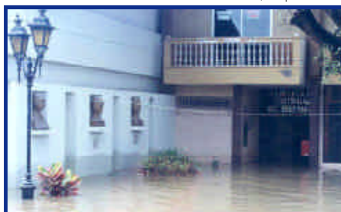
Foto 24. Inundación de las instalaciones de la Casa de la Cultura Ecuatoriana (núcleo de Manabí) (abril de 1998).
