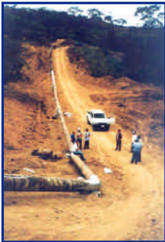
Foto 45. Tubería recuperada, que ha sido desplazada por deslizamientos (octubre de 1998).
