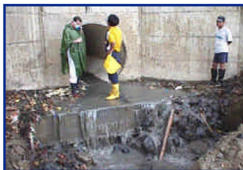
Foto 22. Descarga de las aguas de lluvia. Se observan el color del agua servida producto de las conexiones clandestinas y los desechos acumulados en la boca del desagüe. No existe ningún elemento para proteger el ingreso de las aguas del río (julio de 1999).
