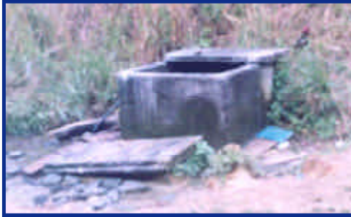
Foto 43. Cámara de válvula de aire mal utilizada por los habitantes del sector, ya que permanentemente escapa agua, lo que hace que el suelo se sature y aumente el peligro de deslave (febrero de 2000).
