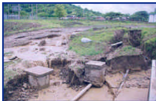
Foto 21. Instalaciones eléctricas en el suelo, cámara de válvulas y tuberías socavadas por el desborde del estero El Zapallo, grietas y sedimentos en las instalaciones de la planta Cuatro Esquinas (febrero de 1998).
