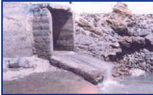
Foto 12. Alcantarilla de aguas de lluvias vertiendo aguas servidas al mar (Yacht Club de Manta, febrero de 2000).
