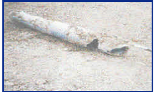
Foto 31. Tubería de PVC fallada por aplastamiento en el deslizamiento de tierras, Simbocal (agosto de 1999).
