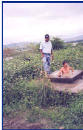
Foto 33. Cámara de válvula para derivar el agua al tanque de San Agustín. Se observa a un trabajador reparando el daño de la fuga del agua (octubre de 1998).
