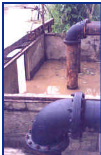
Foto 14. Captación de agua cruda en la estación de bombeo Las Pulgas, en el río Portoviejo (febrero de 2000).
