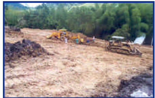
Foto 19. Un deslizamiento destruyó viviendas, carretera y tubería, que se encontraban a 30 m por debajo de la maquinaria (abril de 1998).
