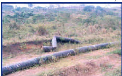
Foto 41. Al fondo se puede observar la tubería de acero deformada y destruida por los deslizamientos de tierra, y la tubería de acero colocada superficialmente (febrero de 2000).
