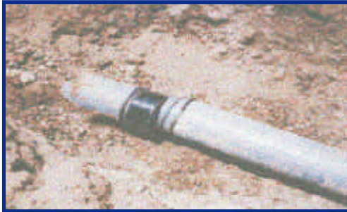
Foto 30. Tubería de PVC desacoplada por deslizamiento. (octubre de 1999).
