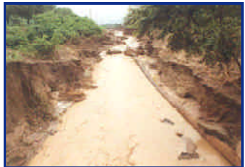
Foto 4. Tubería destruida sobre el Río de Oro. Sector ubicado entre Disensa y estación de bombeo Río de Oro (abril de 1998).
