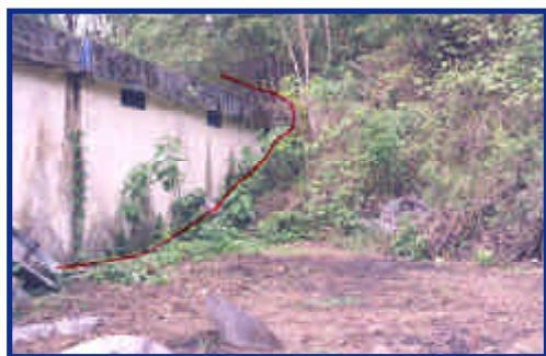
Foto 16. Deslizamiento de la ladera en el tanque de 5.000 m 3 de la planta de Guarumo (febrero de 2000).
