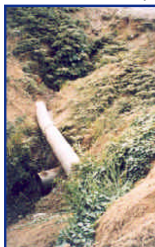
Foto 40. Segundo cruce de quebrada en La Batea. El bloque de anclaje fue destruido (octubre de 1998).
