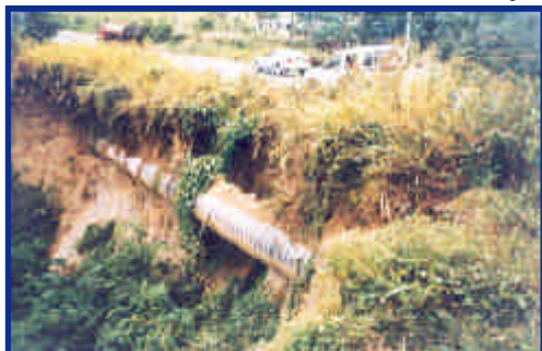
Foto 39. Cruce de quebrada La Batea. La tubería que estaba enterrada se encontraba expuesta y desprotegida (octubre de 1998).
