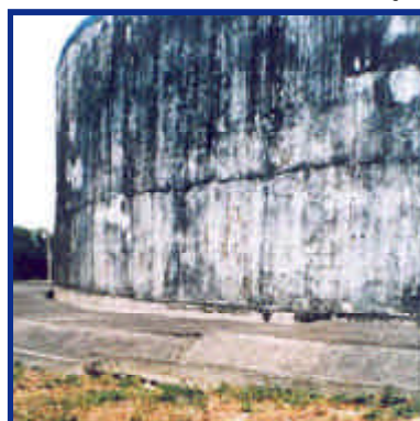
Foto 50. Tanque de Atacames. Es importante observar el desplazamiento vertical de la acera con respecto a la estructura del tanque. La destrucción de la cuneta y la grieta en el terreno son evidentes (octubre de 1998).
