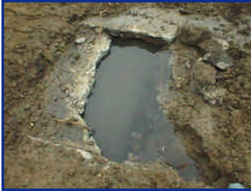
Foto 26. Tubería de aguas servidas destruidas por la acción de los gases sobre la parte superior del hormigón (octubre de 1999).
