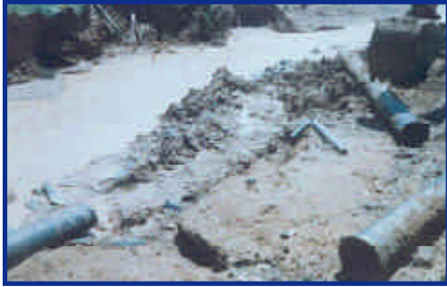
Foto 1. Rotura de la tubería de agua potable en el cruce de Río de Oro (enero de 1998).
