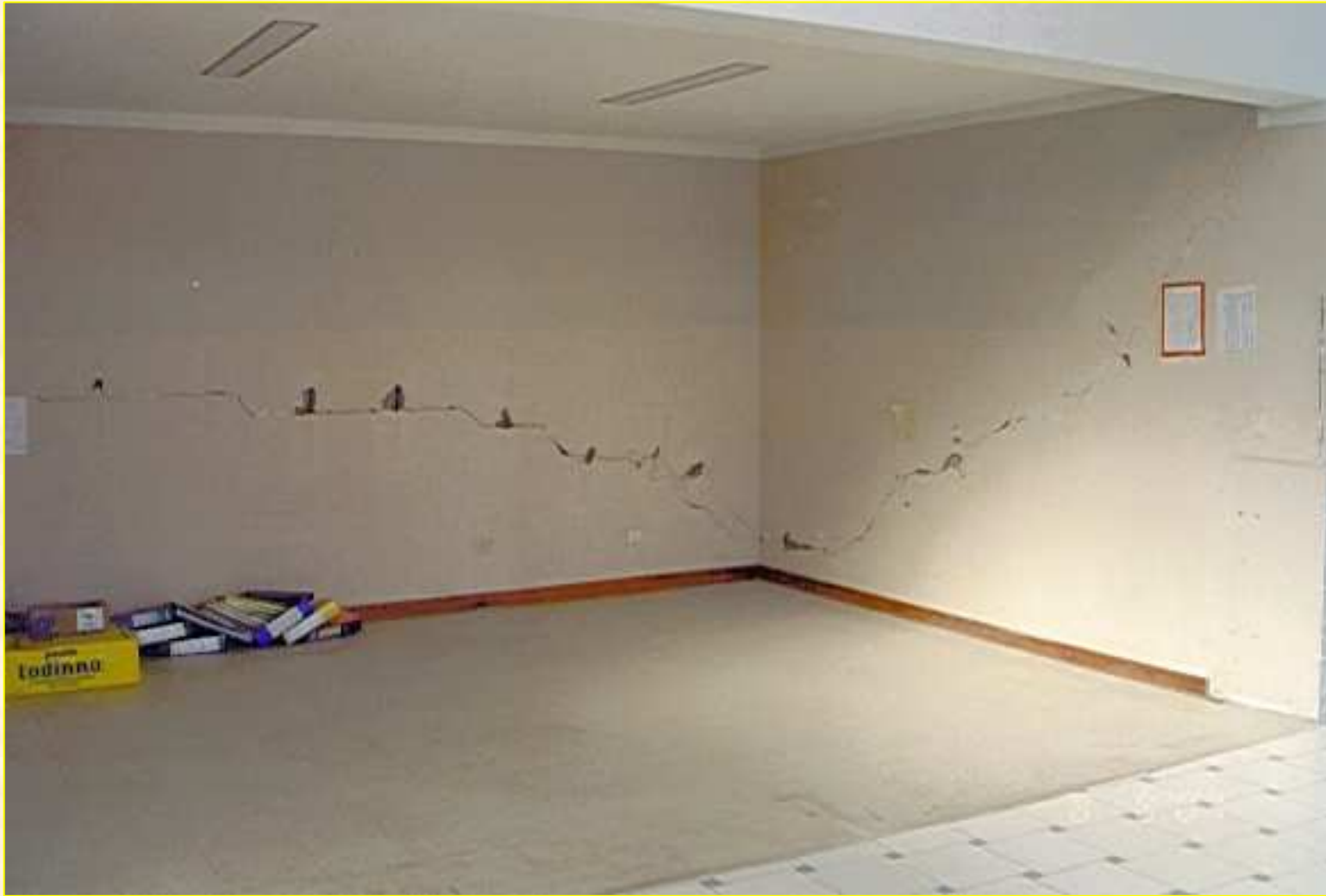
FALLAS POR EXPANSIÓN DE SUELOS EN EL CENTRO DE SALUD DE SAN ANTONIO - MOQUEGUA
