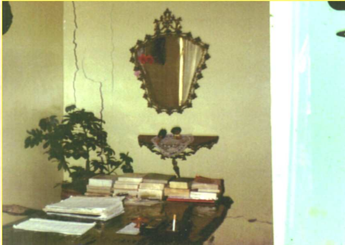
DAÑOS EN CONSTRUCCIONES LIVIANAS-ARCILLAS EXPANSIVAS
