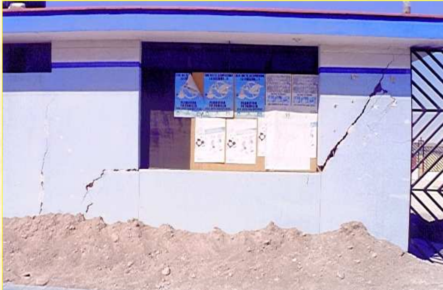
FALLAS POR EXPANSIÓN DE SUELOS EN EL CENTRO DE SALUD DE SAN ANTONIO - MOQUEGUA
