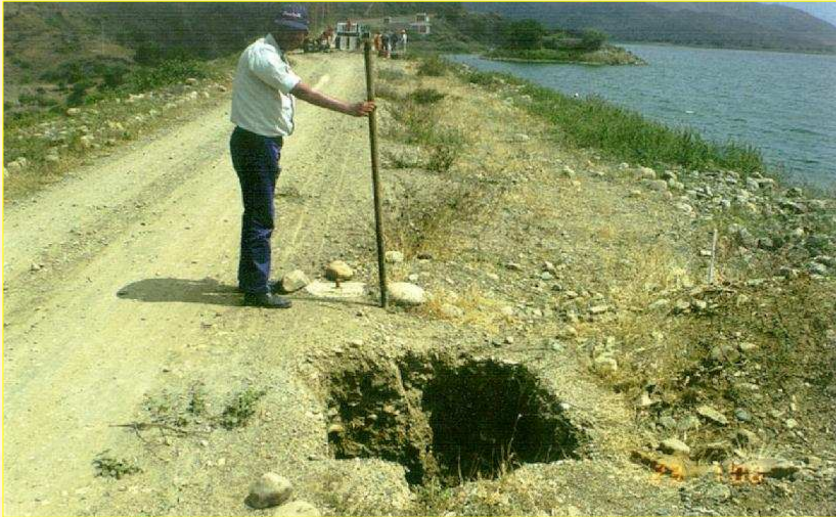
Deslizamiento producido en el talud aguas arriba de la Presa Tinajones
