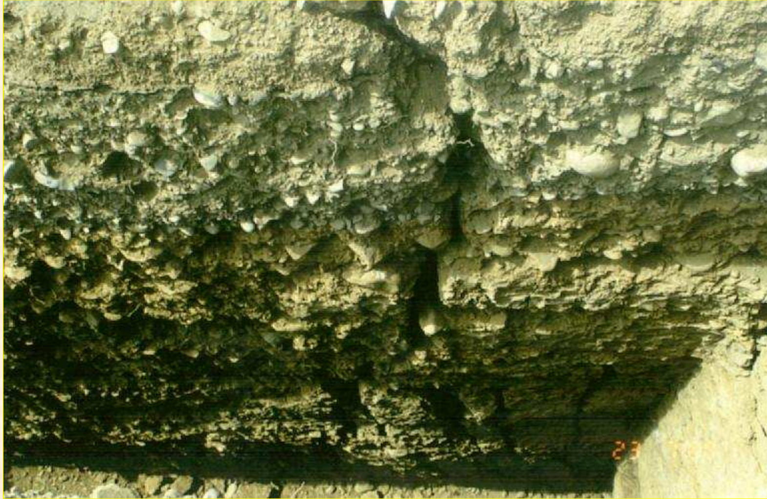
Grieta producida en el talud aguas arriba de la Presa Tinajones
