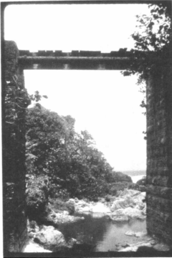
Los componentes vulnerables probablemente sufrirán daño estructural
