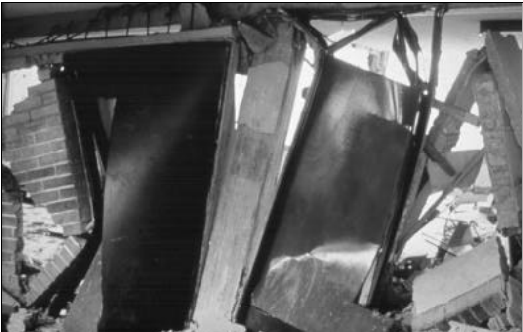
Fotografía 5. Falla de columnas por falta de sismorresistencia
