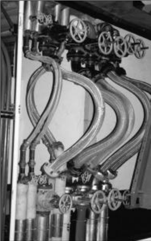
Fotografía 21. El uso de tuberías flexibles en zonas críticas como juntas de dilatación sísmica, uniones con equipos y cruce de edificios, ayuda a reducir la vulnerabilidad.
