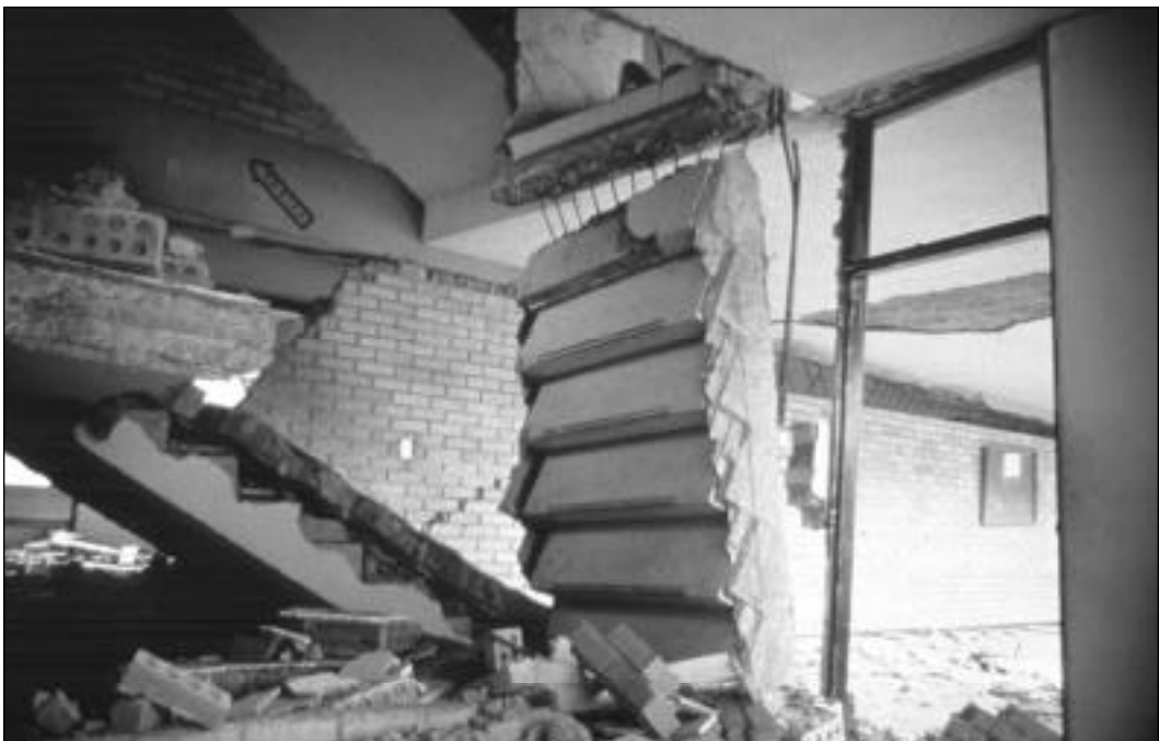
Fotografía 6. Colapso de escalera por falta de sismorresistencia, que evita cualquier tipo de evacuación.
