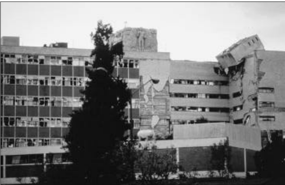
Fotografía 8. Concentraciones de masa, tales como estanques de agua en el techo de hospitales pueden producir daños que comprometan el funcionamiento del hospital.
